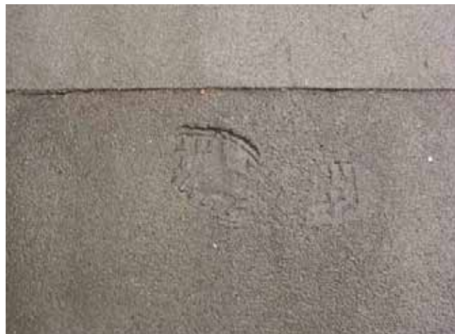
Fot. 24 Uszkodzenie mechaniczne nadmiernie rozgrzanego materiału (tuż po wbudowaniu)
